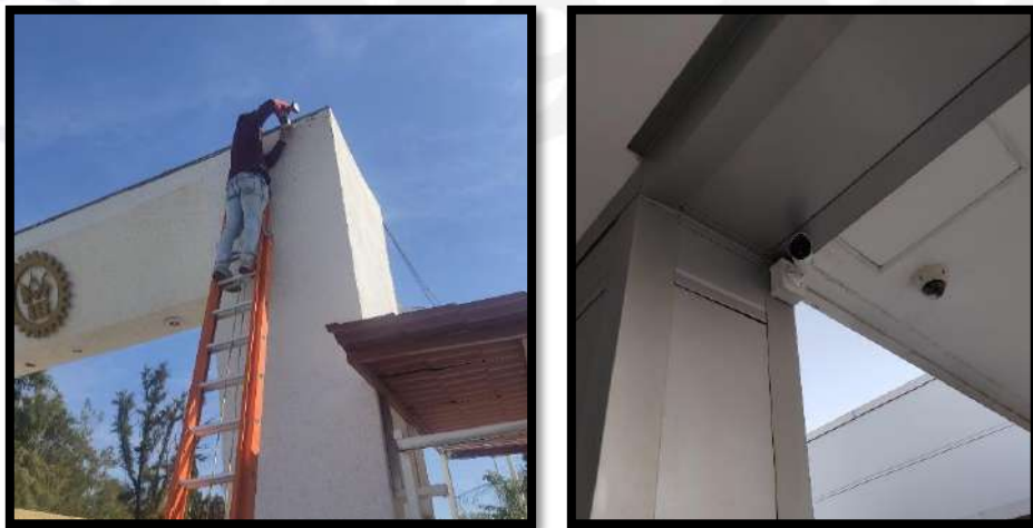
Figura 136. Mantenimiento preventivo y correctivo de circuito cerrado de video vigilancia
